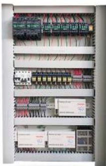
Tủ điều khiển trung tâm (Central control cabinet)
